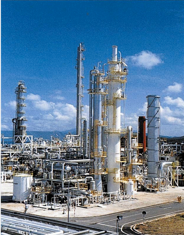
Capture post-combustion de CO 2 sur une centrale électrique à gaz en Malaisie (0.2 MtCO 2 /an).
